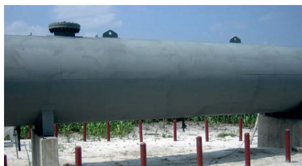
Belzona 6111 обеспечивает катодную защиту металлических поверхностей емкости
