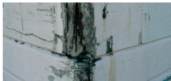
Сильно поврежденный угол
