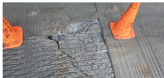
Трещина в бетонной плите создавала угрозу дорожной безопасности
