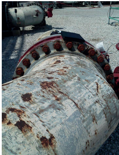
Питтинговая коррозия на трубе
