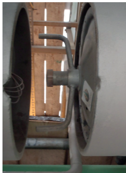
Муфта с питтинговыми повреждениями
